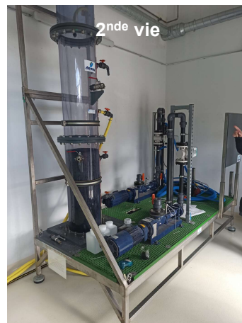
Pilote CarboPlus® de la STEP de Penthaz (traitement des micropolluants STEP)
